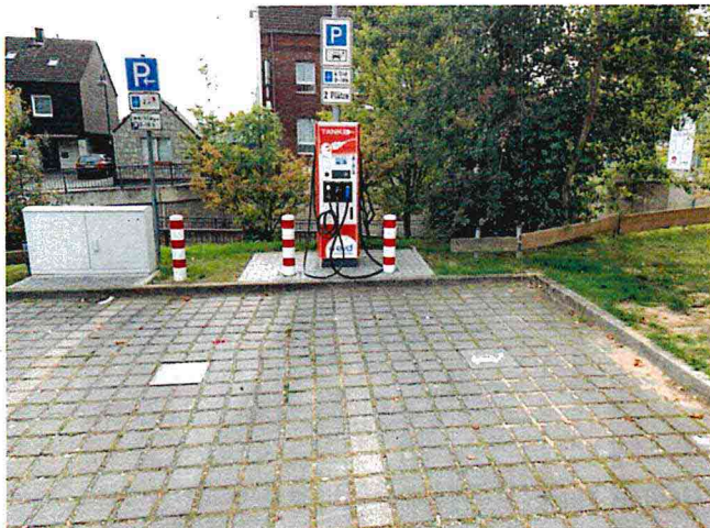
Schnelllader Bahnhof Nievenheim
