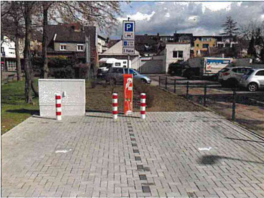
Normallader Nettergasse, Zentrum
